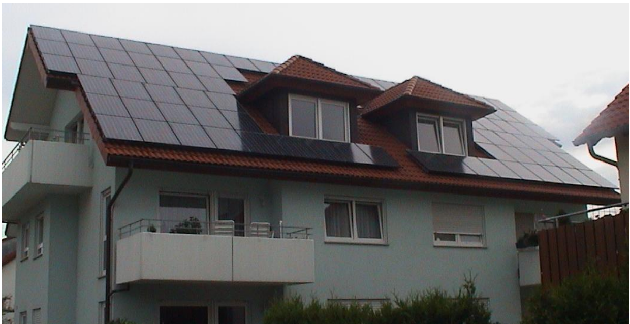
Abbildung 1: Dachanlage mit idealer Süd-Ausrichtung aber ständiger Verschattung der unteren PV-Module durch die Dachgauben
