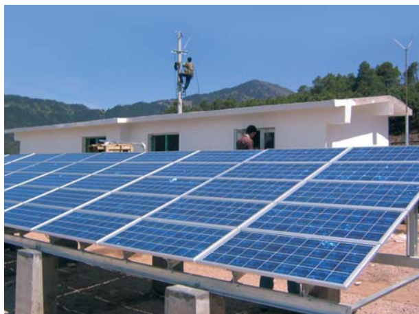
Fig. 9.3 : Approvisionnement électrique d'un village en Chine
