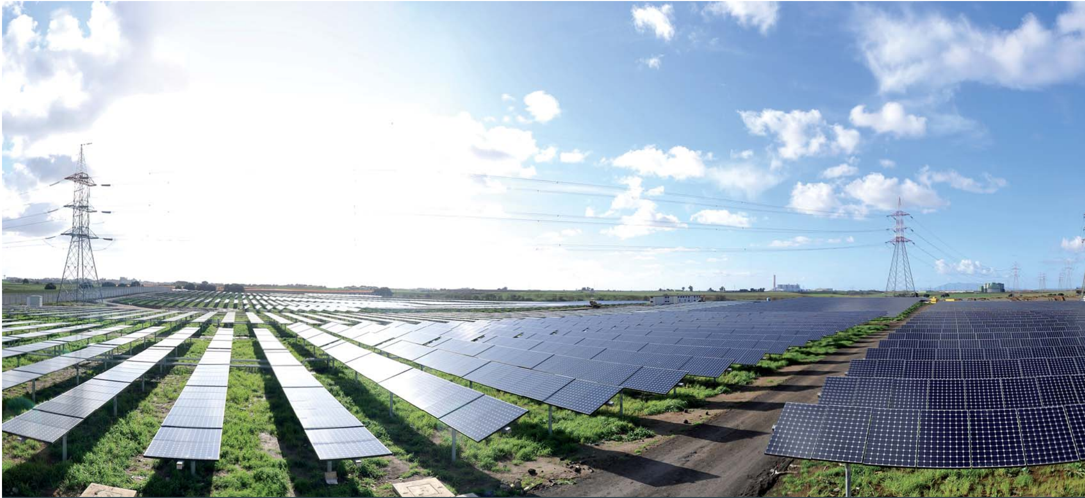
SOLAR PARK MONTALTO DI CASTRO
